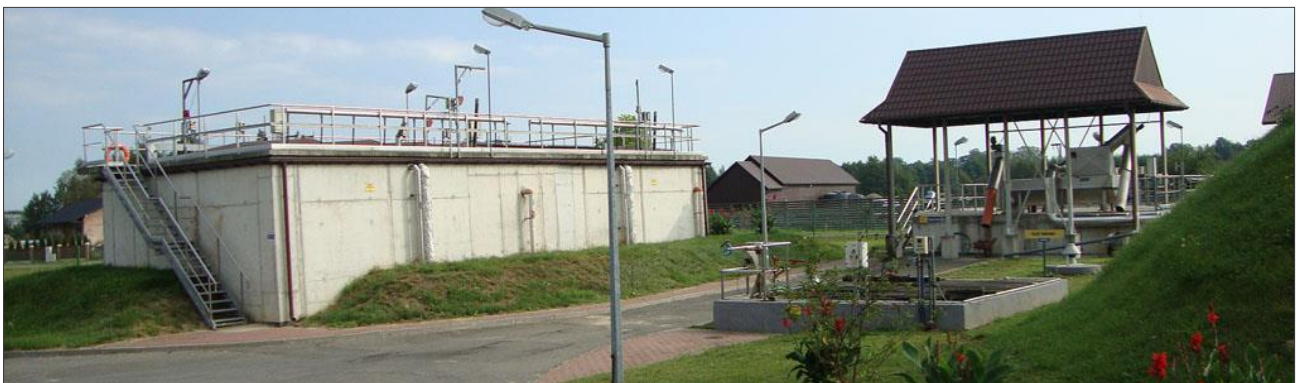
Fot. Oczyszczalnia ścieków w Skrzyszowie.
