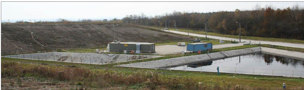
fol. Kontenerowa oczyszczalnia odcieków
